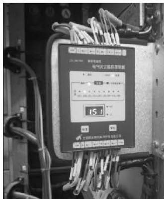
图5 火灾监控探测器所测漏电电流
